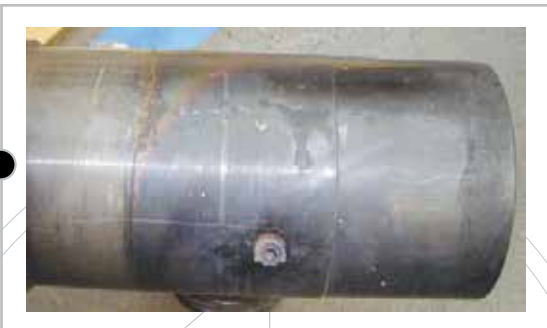
Esempio di surriscaldamento Overheating example
